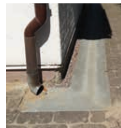
Betonrende til tagvand
