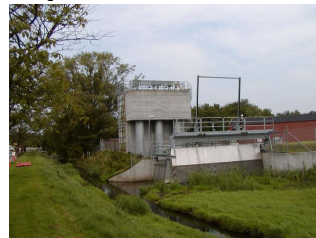
Aflastepumpestationen ved Pøle Å
